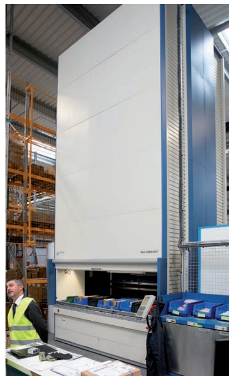
La tour de stockage dynamique comporte 49 plateaux pour les petites pièces qui sont livrées en colis et non sur palettes. © PP
