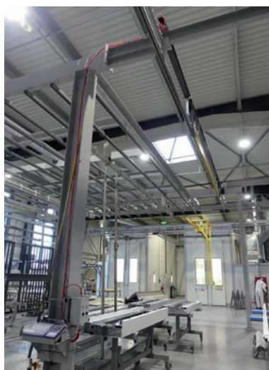
7. Une fois peinte, la partie basculante est pesée par ce rail jaune au plafond. En effet, toutes les portes basculantes ont besoin d'un contre-poids et il faut connaître leur poids précis pour fabriquer le contre-poids qui accompagne chaque porte basculante. Le poids est envoyé à la station de préparation des contre-poids, associé à l'identification de la porte. © PP
