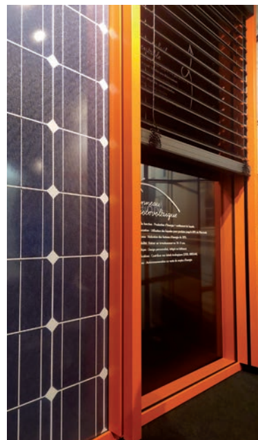
Selon le fabricant, la façade en panneau photovoltaïque contribuerait à fournir jusqu'à 60 % de l'électricité du bâtiment. Avec une production garantie « jusqu'à 150 kWh/m 2 /an. »
