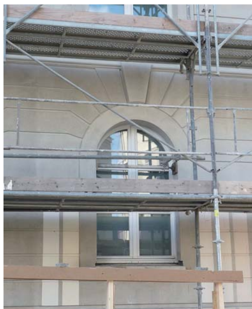
Menuiseries bois cintrées pour la façade XVIII e reconstruite à l'identique de l'Hôpital des 4 Villes.
